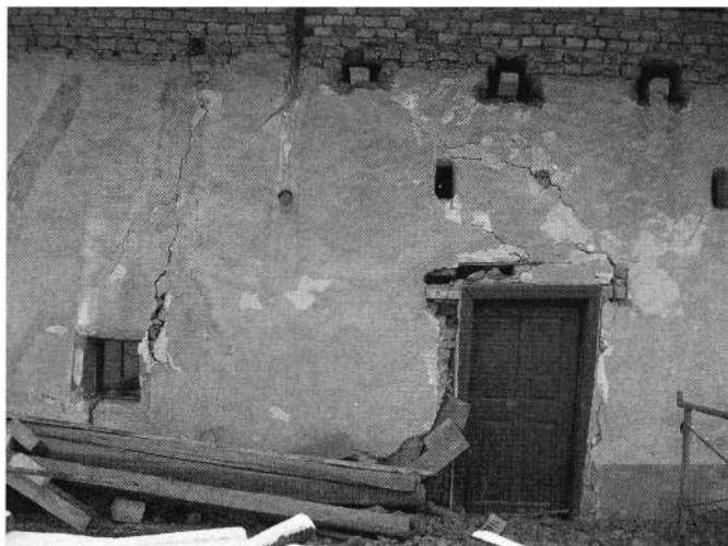
Obr. 3. Trhliny způsobené nedostatečnou hloubkou založení a vodou v základové spáře objektu. Foto I. Žabičková 2010.
