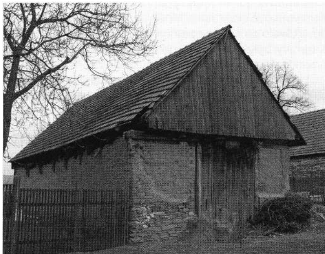
Stodola před opravou staticky narušeného zdíva z nepálených cihel (Hrubá Vrbka u čp. 82). Foto A. Dunajová 2008.
